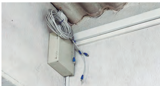
Cableado estructurado de Red en instalaciones deportivas
