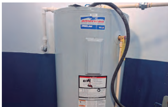
Se renovó calentador eléctrico en el Complejo Deportivo de Totonicapán
