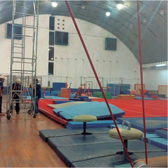
Generadores de electricidad, limpieza general y de cubierta interior de instalaciones
