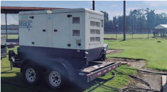
Generadores de electricidad, limpieza general y de cubierta interior de instalaciones
