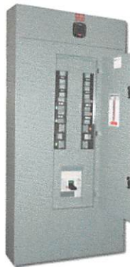
Figura 2. Tableros de Distribución Eléctrica / Tablero Industrial
